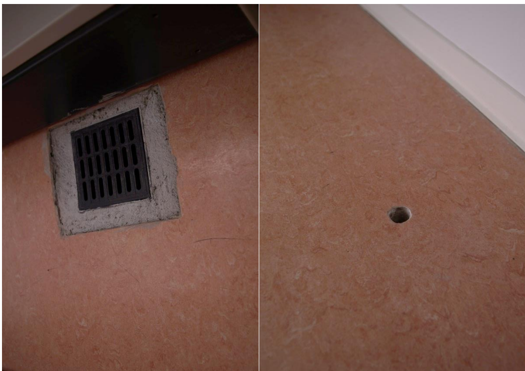
Slika 17: Kanalizacijski šahтови kroz koje su izbijale fekalije
