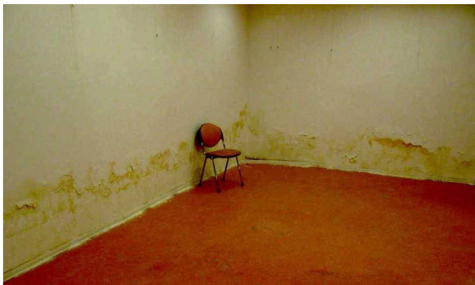
Slika 15: Oštećenja nastala tijekom poplave na zidovima audiovizualnog odjela
