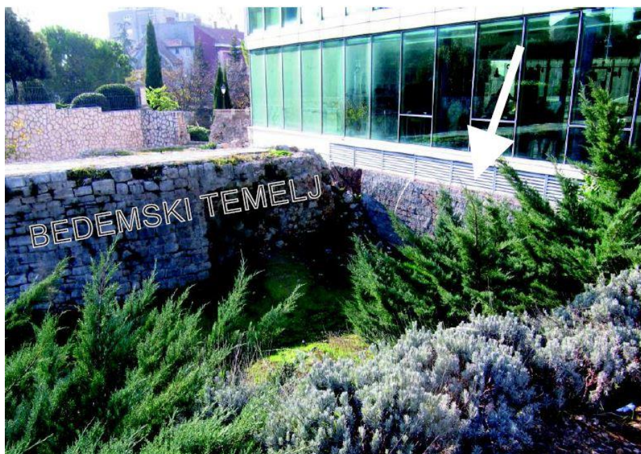
Slika 24: U dnu bedemskog temelja treba otvoriti rupu za odvodnu cijev profila 300 mm, da se kišnica odvede u ostali dio iskapanog okoliša, jer se ispred stvori bazen od kišnice iz kojeg se u enormnim situacijama kišnica preko zračnih rešetki prelije u kanal i u prostorije.
