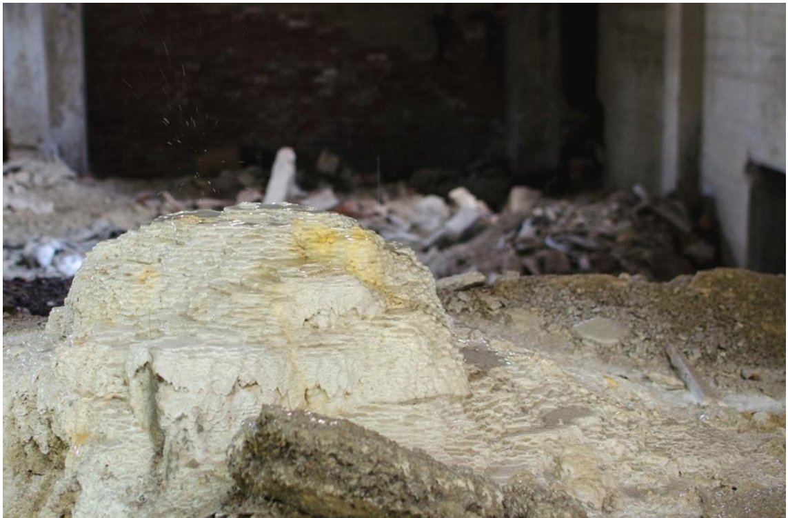
Slika 51- Sediment stalaktita na dnu konstrukcije
