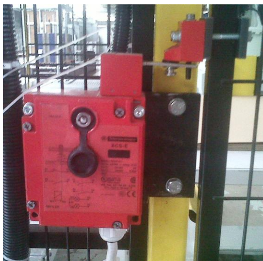
Slika 13 Vrata koje kontrolira elektromehanički granični prekidač
