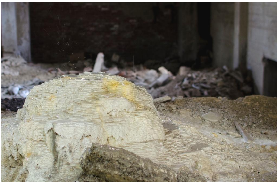
Slika 51- Sediment stalaktita na dnu konstrukcije
