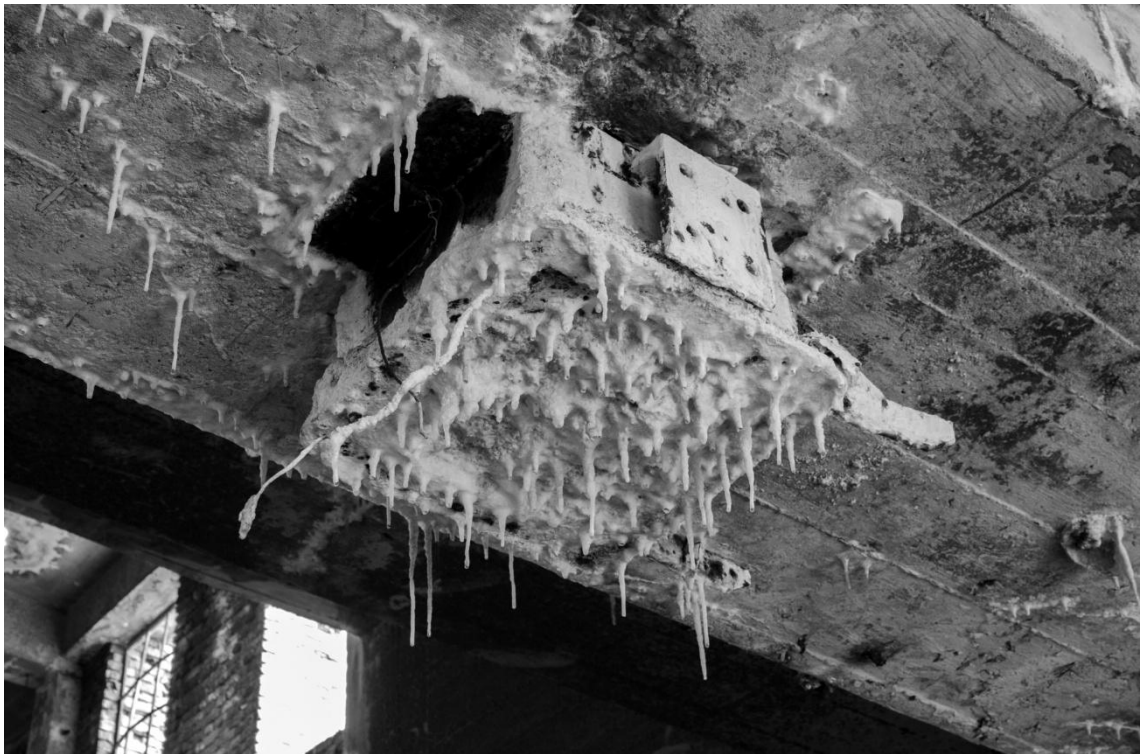
Slika 50- „Stalaktiti“ na konstrukciji
