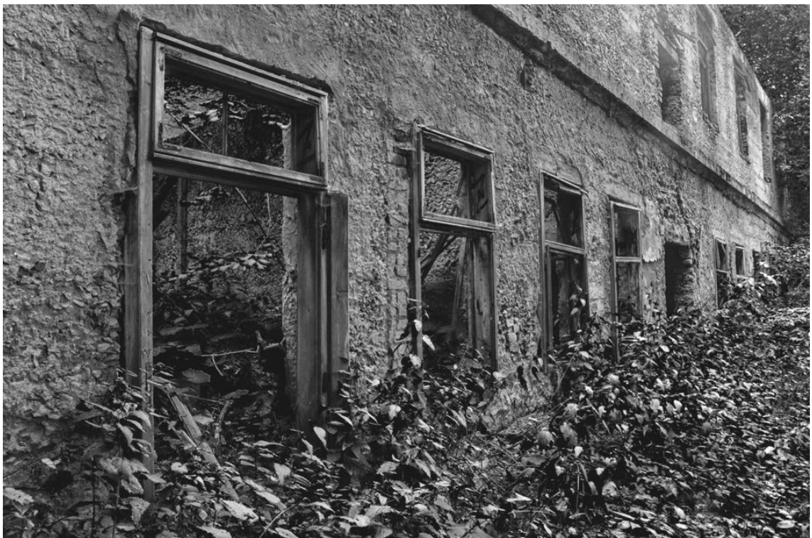
Slika 42- Napušteni objekt kompleksa
