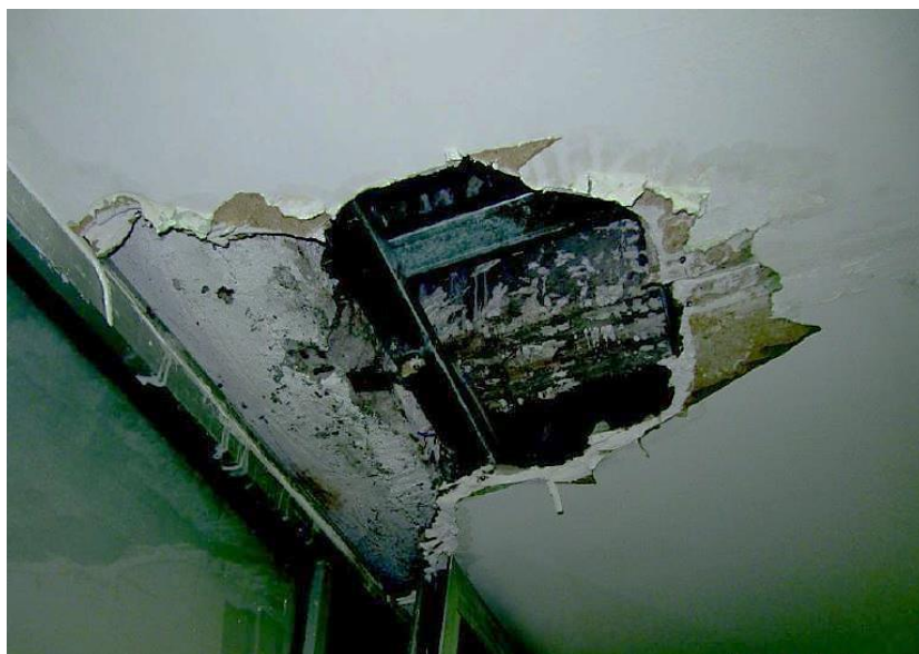
Slika 16: Oštećenja nakon poplave na stropu u spremištu hemeroteke
