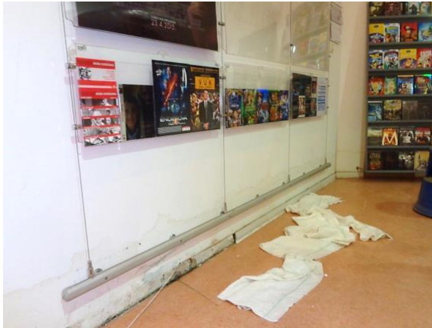
Slika 23: Nadiranje vode na podu uza zid u Audiovizualnom odjelu nakon kiše 28. listopada 2015.
